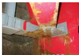
橋桁端部の劣化
